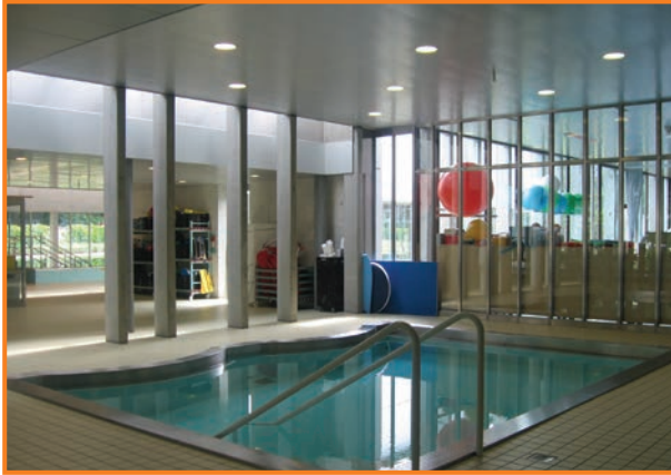
Resim VII.4.a, b, c. Havuz aydınlatmaları
